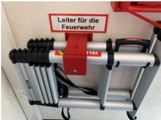
Beispiel einer möglichen Leitersicherung
