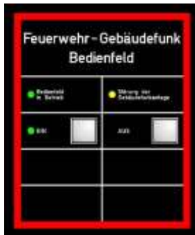
Beispiel eines Feuerwehr-Gebädefunk-Bedienfeld
